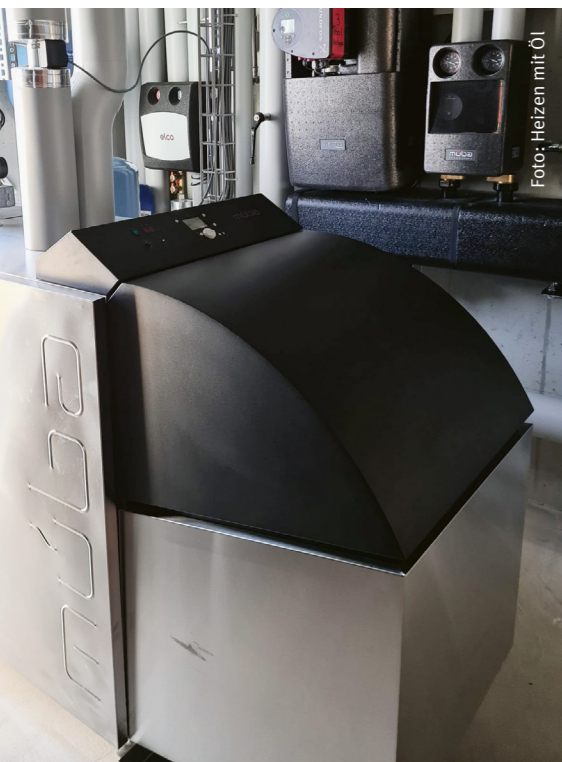
Brandneue Ölheizung im Technikraum des H2O GYMFIT an der Hauptstrasse in Holziken.
